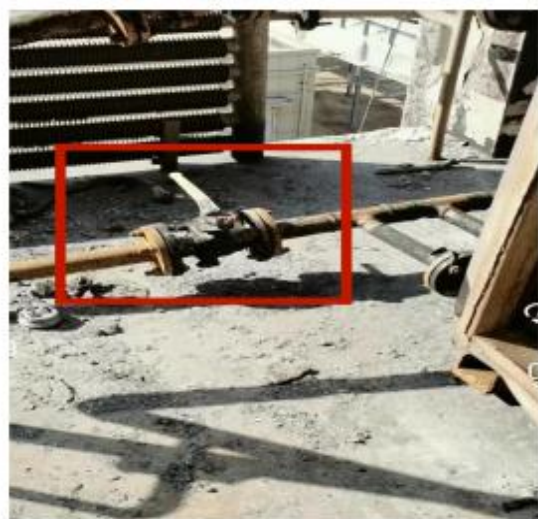
(照片 10) 翅片管换热器冷水管线阀门处于关闭状态
