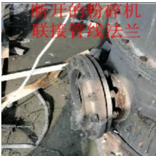
(照片 9) 断开的粉碎机联接管线法兰
